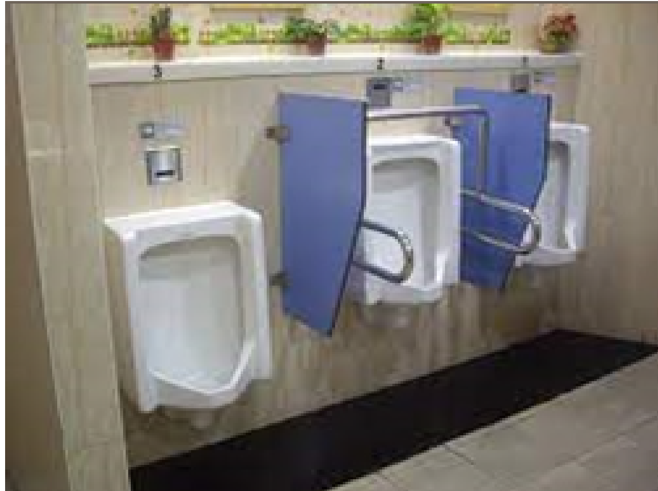
廁所盥洗室-一般廁所無障礙小便器
